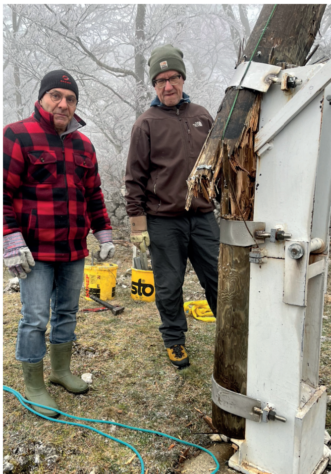
Gürkan Celikbilek et Lionel Socchi constatent les dégâts : il va y avoir bien du boulot ! (db)
